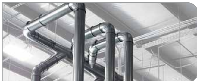
Quick-Fit rörsystem installerat.
