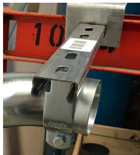
Bøj monteret på en bjælke ved brug af Rørholder og Bjælkeklemmer
